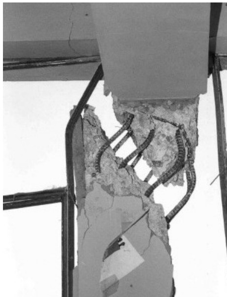
Figura 2.3. Fallo de una columna por cortante
